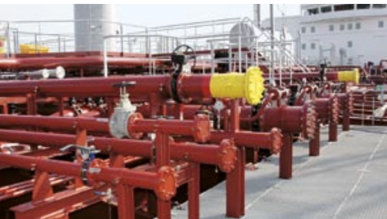
Ladungsdeck mit Übergabestation
