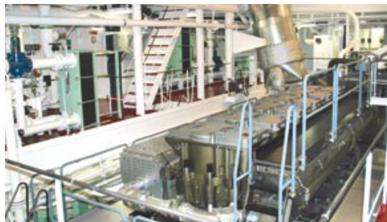
Blick in den Maschinenraum
