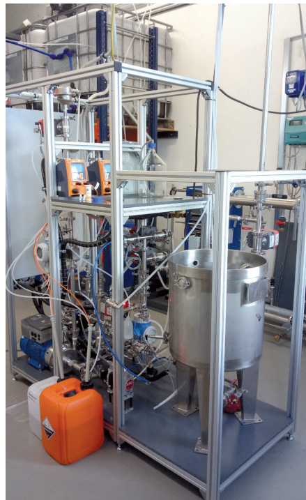
Abb. 2: Membrananlage zur Reinigung von Scrubber-Abwasser
